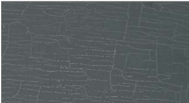
Îmbinarea a fost deteriorată de radiația UV.
