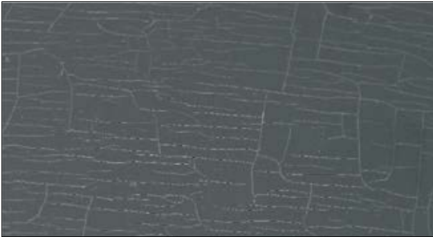
Zaradi UV-sevanja je spoj poškodovan povsod.
