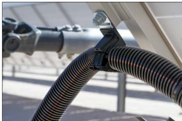
Zarządzanie przewodami na trackerach w instalacji fotowoltaicznej.
