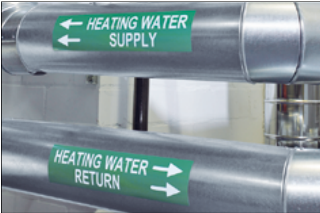
Stort og synlig merking av rør.
