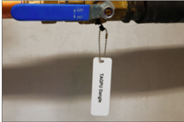
Stort og synlig merking av rør.
