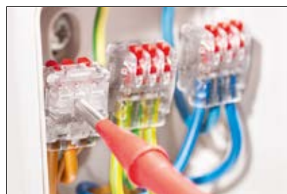
Testhåll på undersidan av toppklämman.
