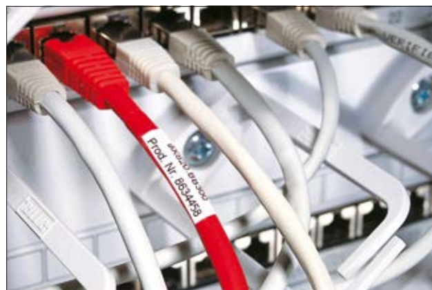
Skyddslamineringen ger ett optimalt skydd mot nötning och miljöpåverkan.
