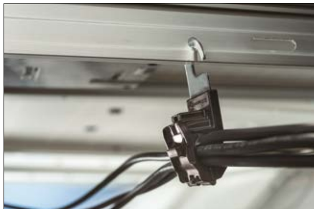
Obejma Ratchet P-Clamp zamocowana do panelu fotowoltaicznego.
