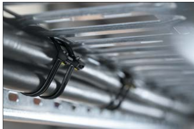
Opaski serii KR zastosowane w korytku kablowym.
