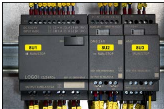
Zastosowanie w rozdzielnicach.
