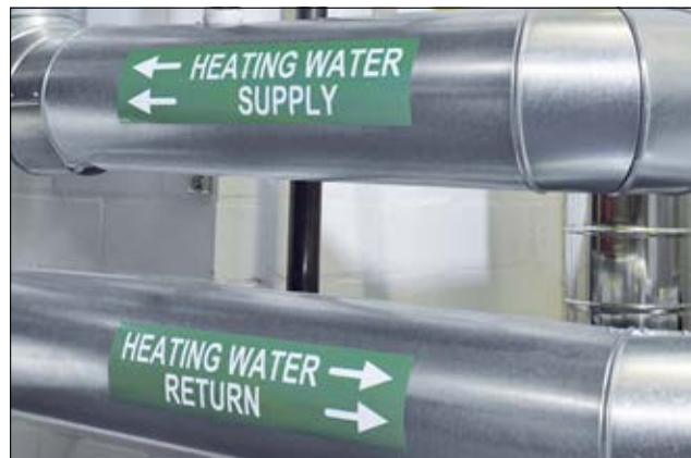
Duże i dobrze widoczne oznakowanie rur.
